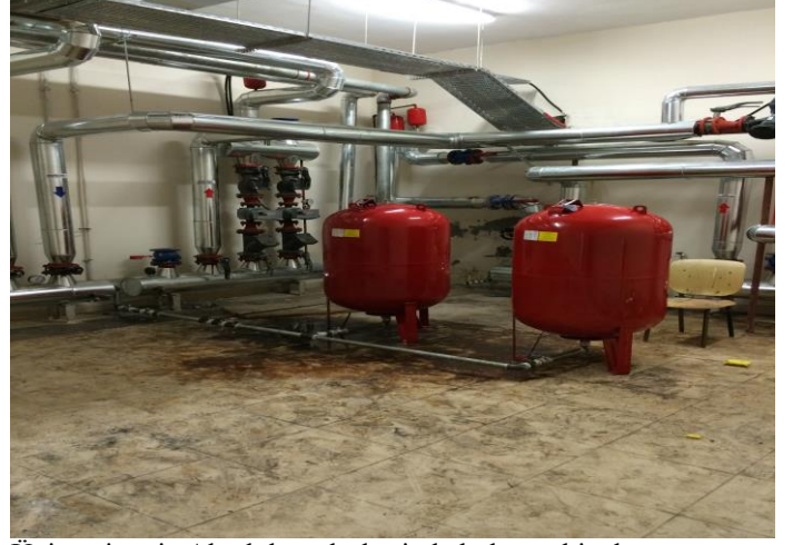
Üniversitemiz Aktuluk yerleşkesinde bulunan binalara ısınmanın daha sağlıklı yapılabilmesi için genişleme tankı takıldı.
